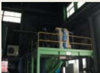
改質施設(汚泥)
