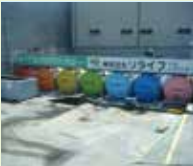
汚水処理施設
